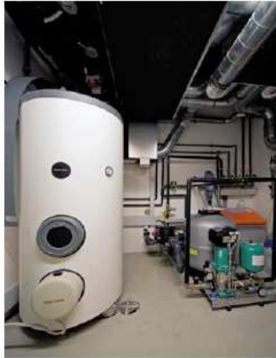
Die Haustechnik sorgt für Wärme und Frischluft.
